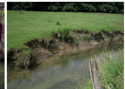
Gestion des érosions de berge
